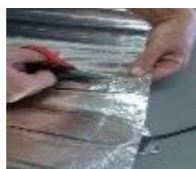
Konec stříhu. POZOR na kabel!
